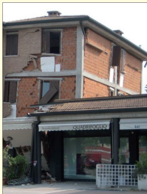
Schädigung von Ausfachungswänden in und senkrecht zur Ebene
