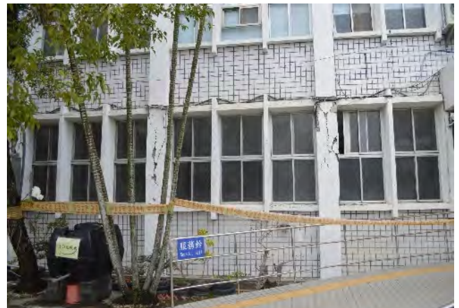
b) Schäden an einer Schule nach dem M6.4 2016 Meiniung Erdbeben
